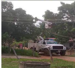
Desprendimiento de guaya dejó sin luz a la comunidad de Santa Bárbara en Ciudad Fiar
