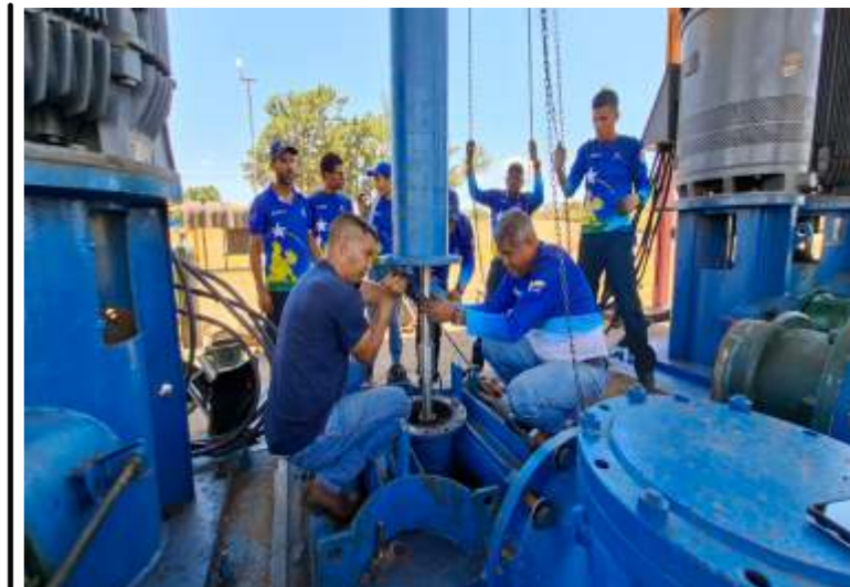
Gobierno Bolivariano instaló equipo de bombeo en el acueducto Puerto Ordaz
